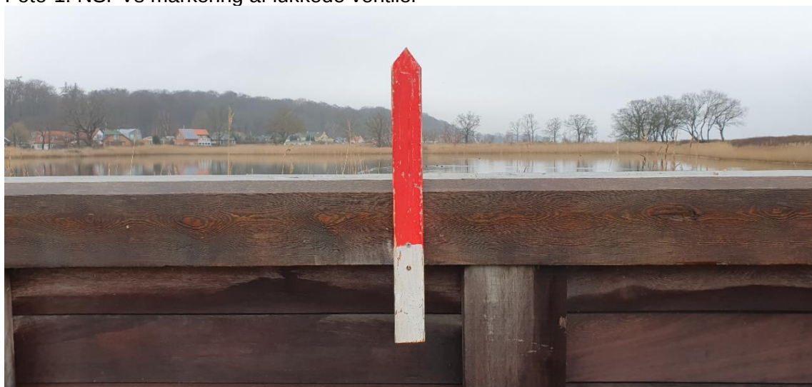
Foto-1: NSPVs markering af lukkede ventiler
